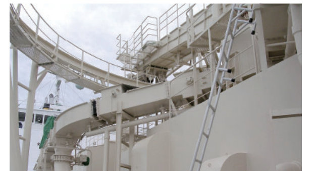
受入旋回エアースライド Loading air slide
