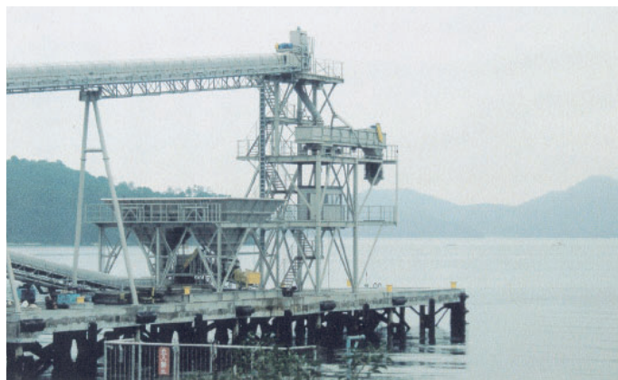
船積み設備用ベルトコンベア Loading for belt conveyor
