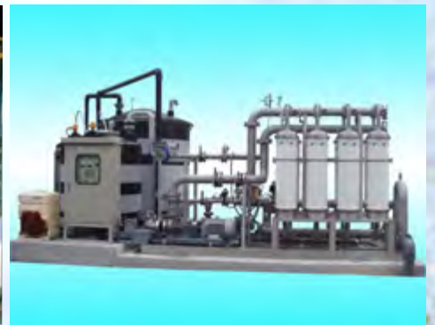
地下水除濁UF装置
