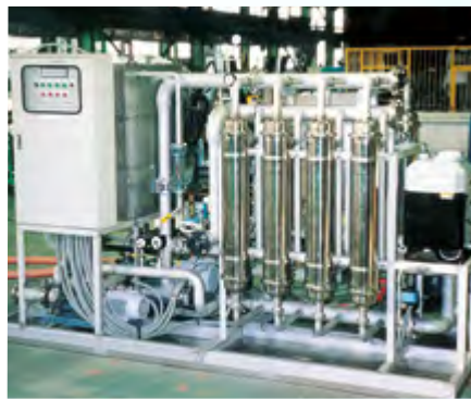
地下水除濁UF装置
